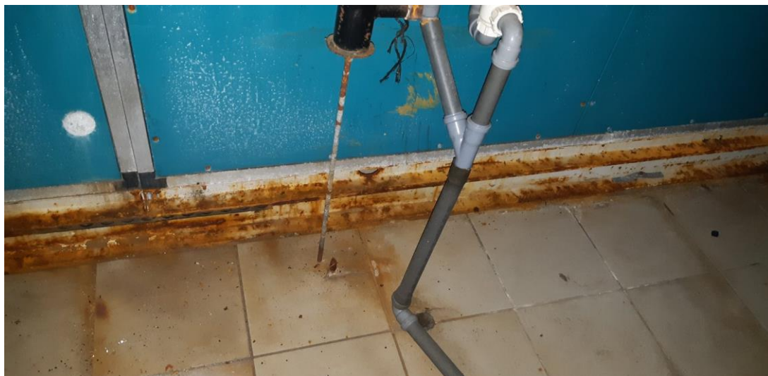
77. ábra: Előrehaladott korrózió a légtechnikai géptérben
