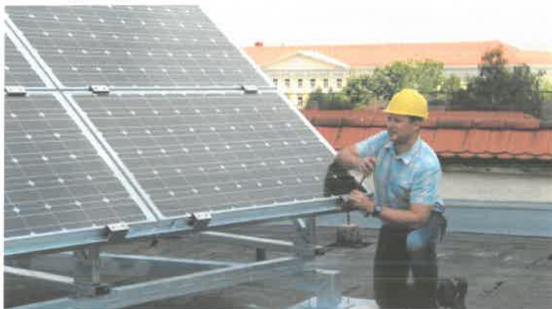
80. ábra: Az első PV projekt Orosházán
