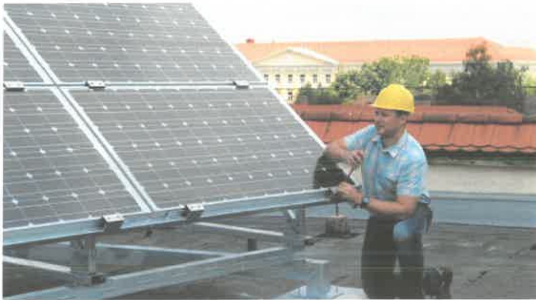
80. ábra: Az első PV projekt Orosházán
